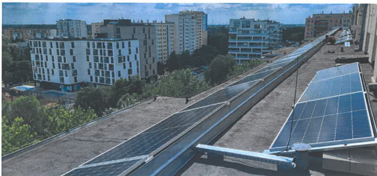
Fot. Panele fotowoltaiczne zamontowane na dachu budynku przy ul. Rozłogi 2
