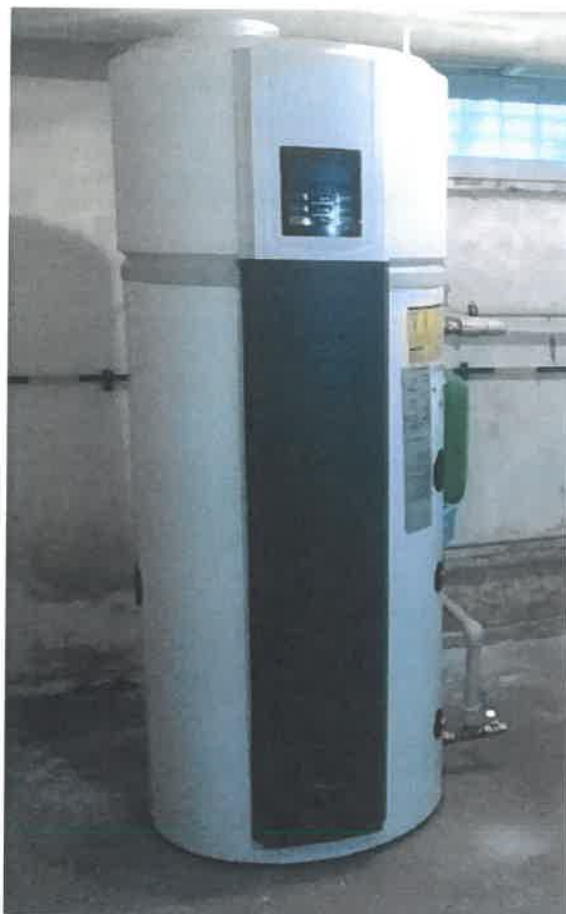
Fot. Pompa ciepła zamontowana w budynku przy ul. Rozłogi 2 dla potrzeb podgrzewu pierwotnego ciepłej wody użytkowej
