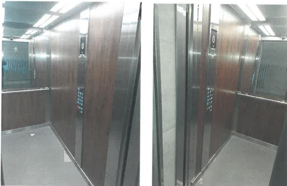
Fot. Wnętrza nowych dźwigów
