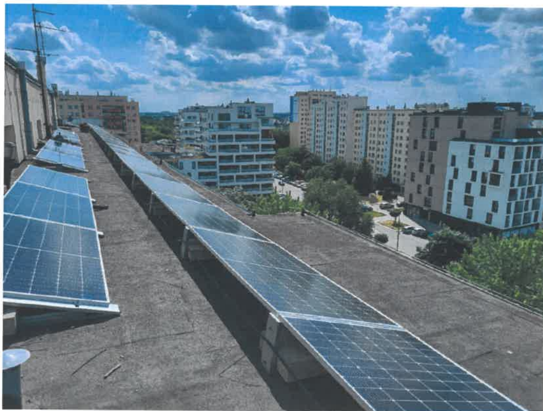
Fot. Panele fotowoltaiczne zamontowane na dachu budynku przy ul. Rozłogi 2
