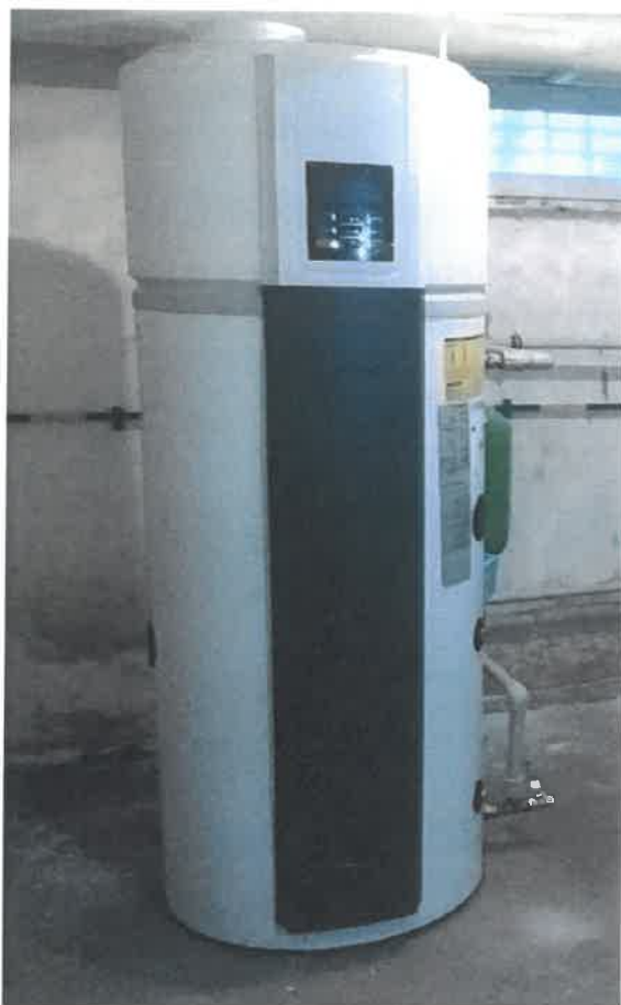
Fot. Pompa ciepła zamontowana w budynku przy ul. Rozłogi 2 dla potrzeb podgrzewu pierwotnego ciepłej wody użytkowej
