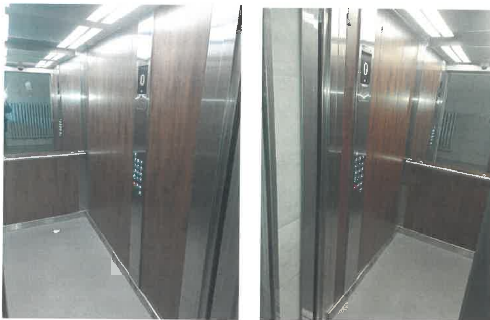
Fot. Wnętrza nowych dźwigów
